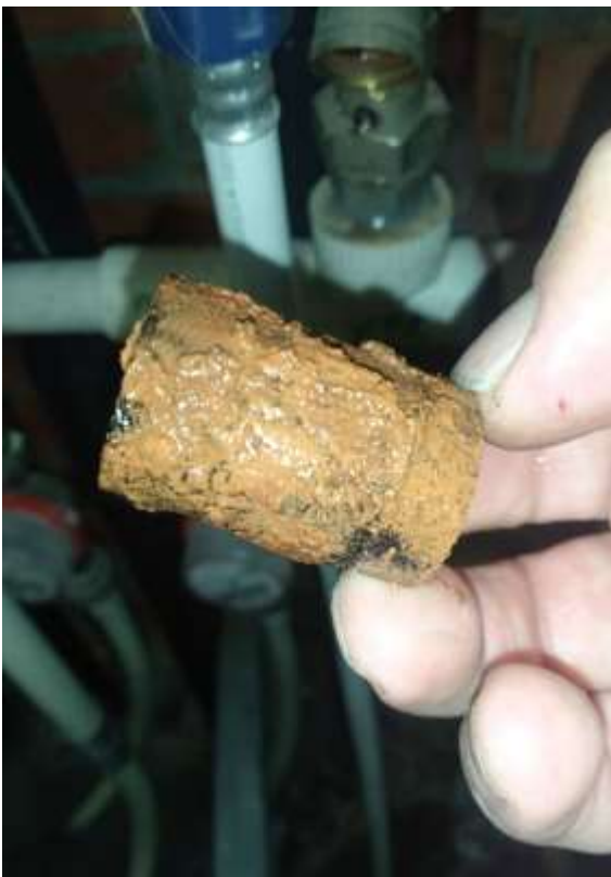
Фильтры ГВС и ХВС забитые грязью
